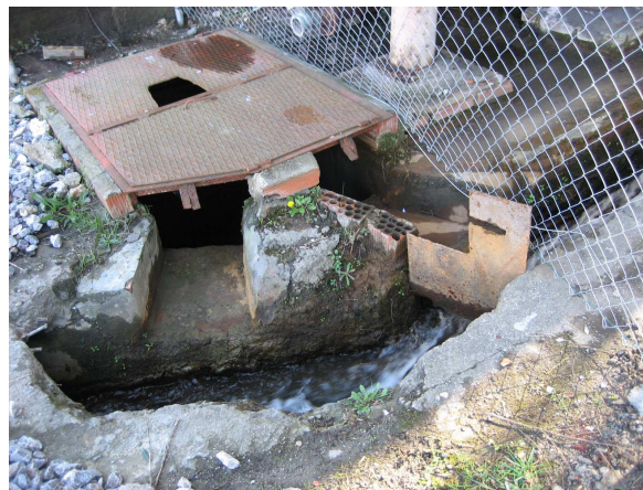
Fotografía 11-2.-Canal de vertido del Pozo Fondón
